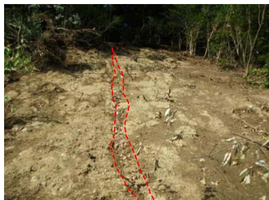
写真-4 崩壊面の状況
