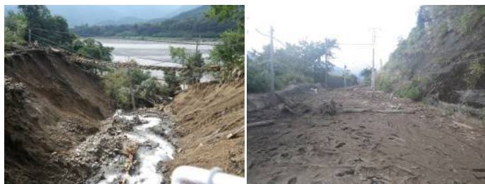
写真-1 盛土崩壊状況 写真-2 崩土流入状況
