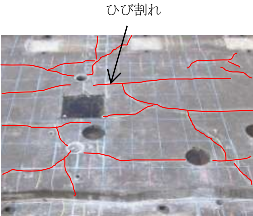
図 1 軌道スラブのひび割れ状況
