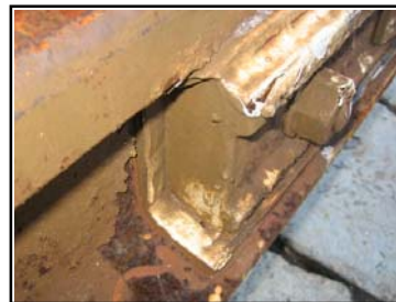
図 2 継目板の設置状態
