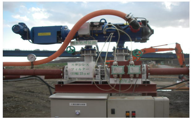
写真-1 ステンレスフィルタ濁水処理装置
