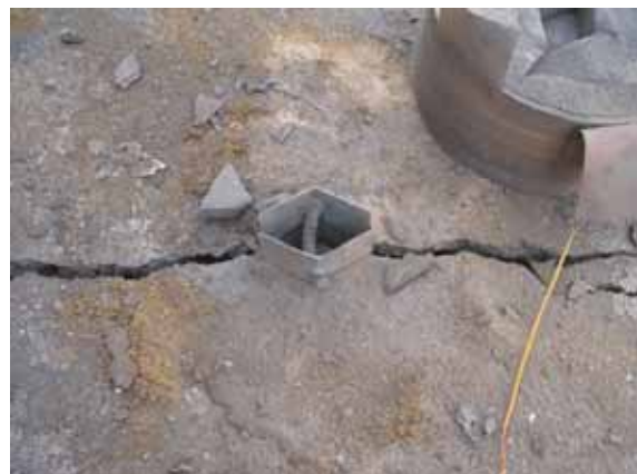
写真－2 装薬ホルダー付近の破断状態
