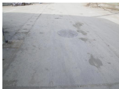
写真-4 対策済みマンホールの例その 2
