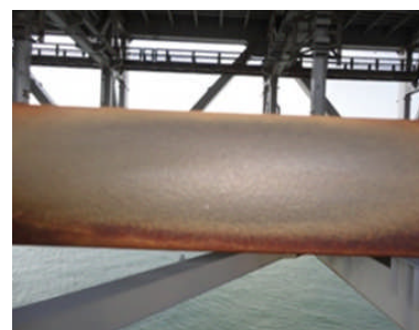
写真-2 表面錆除去後の外観
