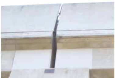
写真-1 下り側桁遊間目開き状況
