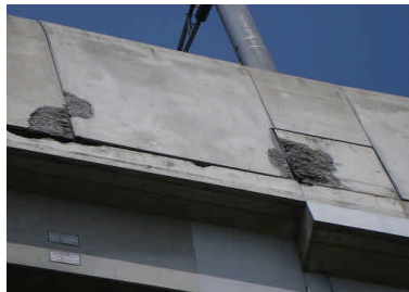
写真-2 上り側破損状況
