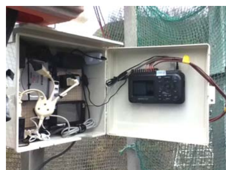
図-2 データ取得部機器設置状況
