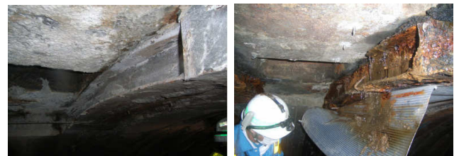
写真-1 鋼材腐食比較（左：健全、右：腐食）
