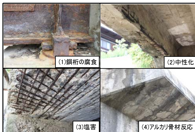
写真-1 香川県内市町管理橋梁における損傷事例
