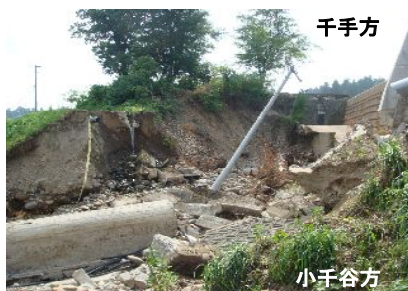
写真-1 提体のり面崩壊
