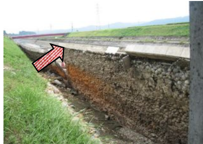
写真-2 護岸壁傾斜
