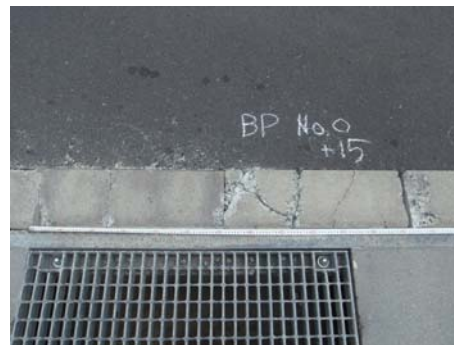
写真-1 境界ブロックの角欠け・ひび割れ状況
