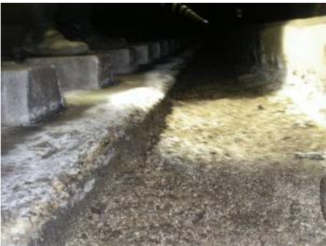
写真－1 道床コンクリートの変状
