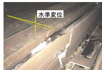
図4 福島トンネル中央通路変状
