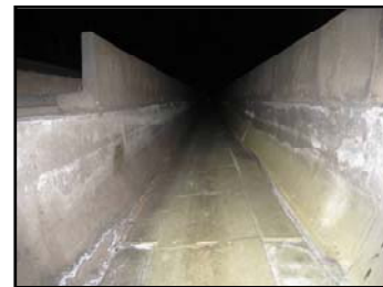
図 8 志賀トンネル中央通路変状
