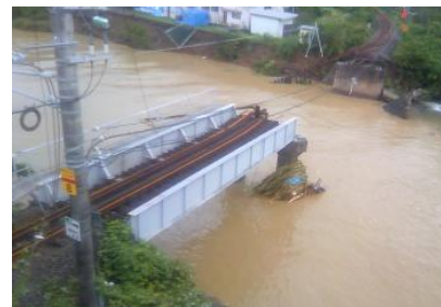
写真-1 橋りょう被害状況
