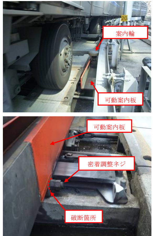
図 1.1 可動案内板外観と密着調整ネジ破断箇所
