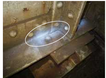
写真1 下フランジ山形鋼の疲労き裂
