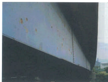
写真-1 一般塗装系の劣化 2)
