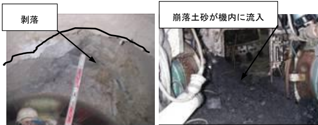
写真-2 テール部地山崩落状況 (マシン後方より) 写真-3 切羽崩落状況 (マシン後方より機内)
