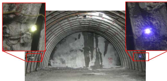
写真-2 「光るロックボルト軸力計」設置状況
