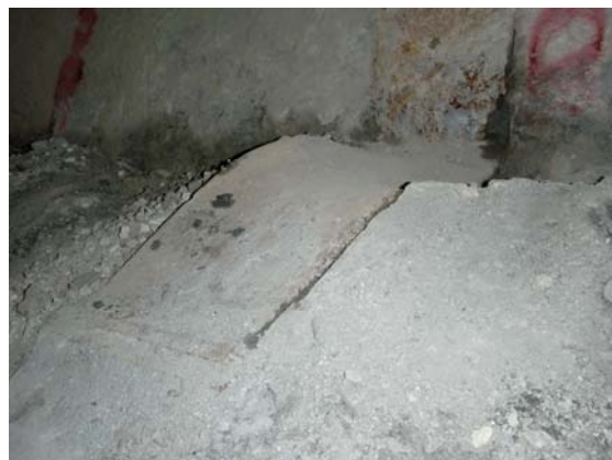
写真-2 箱抜き掘削部の変状（下り線，消火栓）
