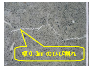
写真-4 ひび割れの状態
