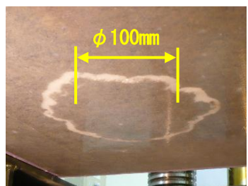
写真-3 剥離の状態
