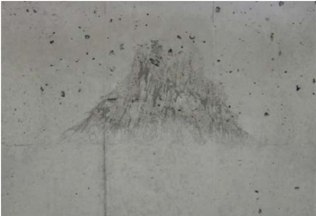
写真-4 型枠に付着したモルタルの跡
