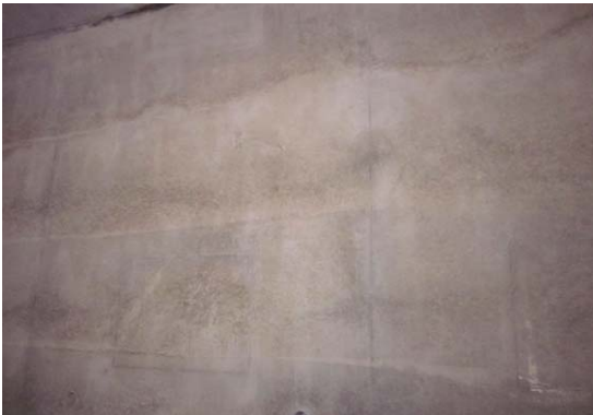
写真-1 壁の表面に発生した打重ね線の例
