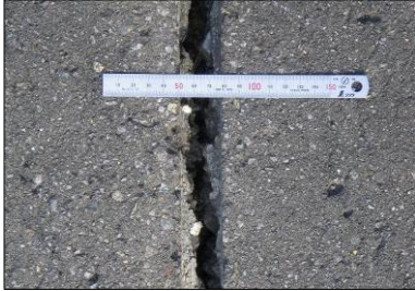
写真-3 既設のクラック部
