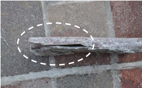
図-2 モルタルと自然石の接着部の状況
