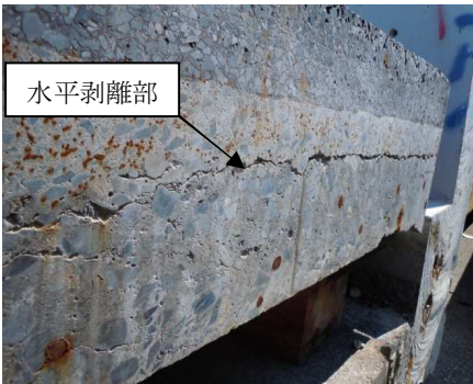
写真－2 水平剥離部の状況
