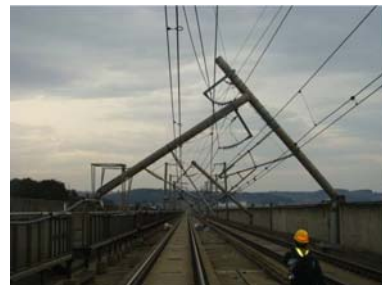
写真-1 PC電化柱損傷状況①
