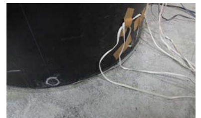
写真-5 柱基部の損傷状況
