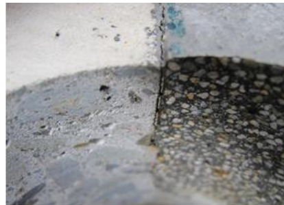
写真-2 打継ぎ境界におけるはく離
