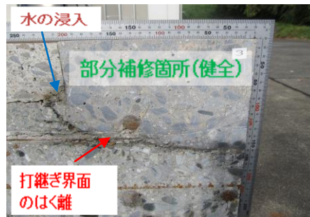
図-4 試験後の補修部変状
