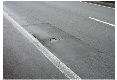
写真-1 床版補修部における再変状
