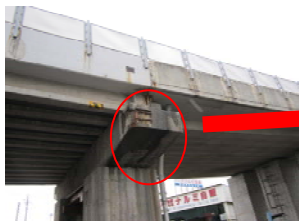
写真-9 張出し部の漏水状況
