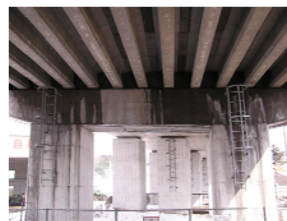
写真-1 掛け違い部の漏水
