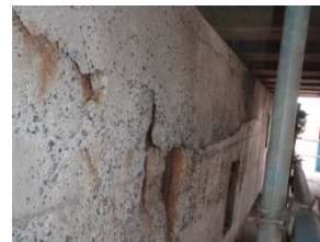
写真-2 漏水箇所のコンクリート
