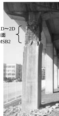
写真－１ 高架橋柱の被災状況
