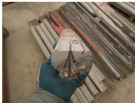
写真-3 12φ7 充填不足状況
