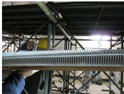
写真-1 下り勾配の空隙
