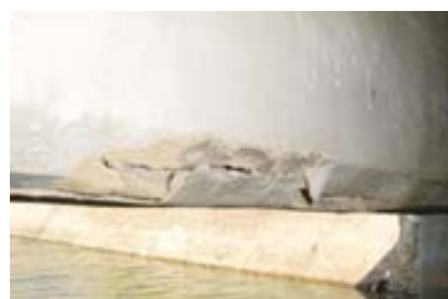
写真-1 補強前の主桁損傷
