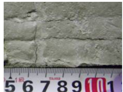
写真1 模擬体下端のひび割れ
