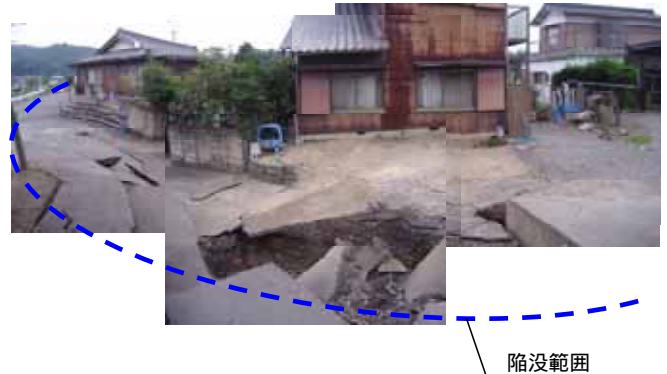
図-1 陥没状況(平成22年10月)
