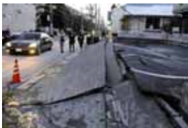
写真-1 液状化による被害
