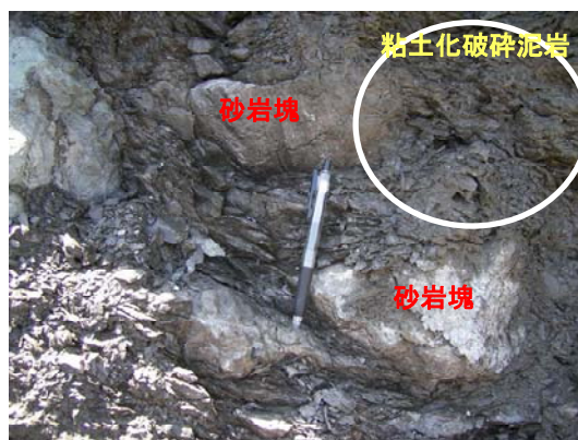
写真-1 破砕泥岩の粘土化状況
