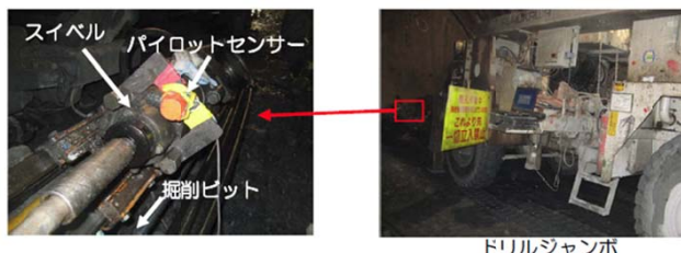
図4 パイロットセンサー設置状況
