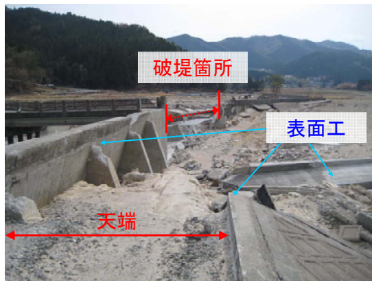
図1 吉浜川左岸堤防の被害状況
