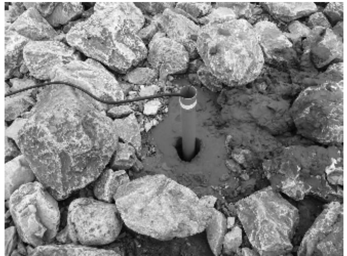
図-4 水位計の設置状況
