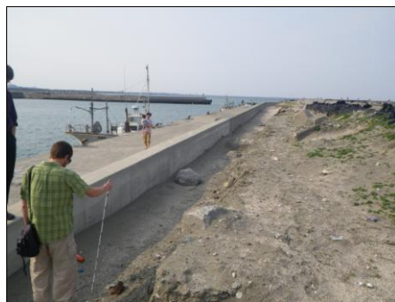
図-1 いづみ市大東港での岸壁裏面の洗掘
