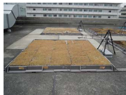
図-3 屋上緑化施設
