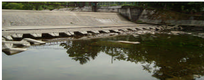
写真1 発電用堰直下流側での浸食状況
