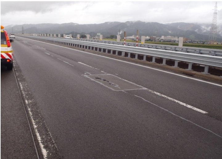
図-1 舗装面の損傷およびポットホール発生状況
