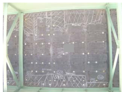
写-1 ハンチ部周辺の不良音
