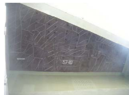
写-3 非常駐車帯周辺の不良音
