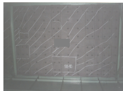
写-2 全面に発生した不良音
