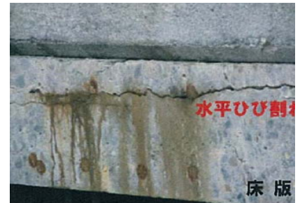
写真-1 水平ひび割れ
