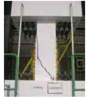
写-2 せん断破壊直後 (PW00、+10/1000)
