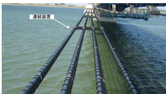
写真-3 実橋の制振対策 (水平ケーブル)
