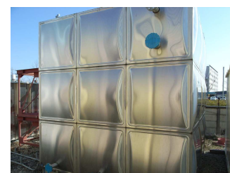
写真1 受水槽タンク (SUS製)
